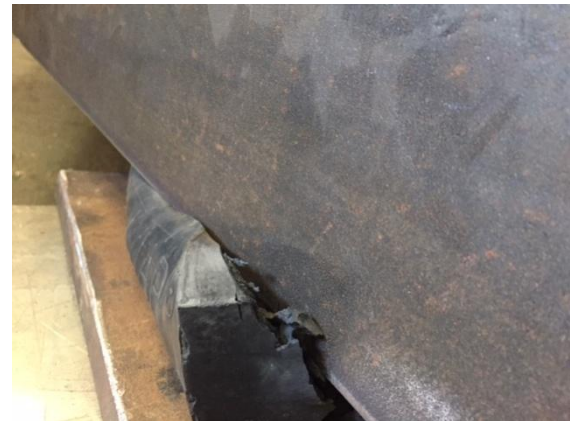
Photo 14 : Ici, la surface inégale a mis trop de pression sur le caoutchouc. Étant donné que le composant ici était constitué de plaques inférieures étroites, une plaque supérieure devrait empêcher le caoutchouc d'être endommagé.
