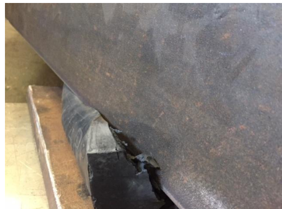
Foto 14: Qui la superficie irregolare ha messo a dura prova la gomma. Poiché il componente qui era costituito da piastre inferiori strette, una piastra superiore dovrebbe impedire il danneggiamento della gomma.
